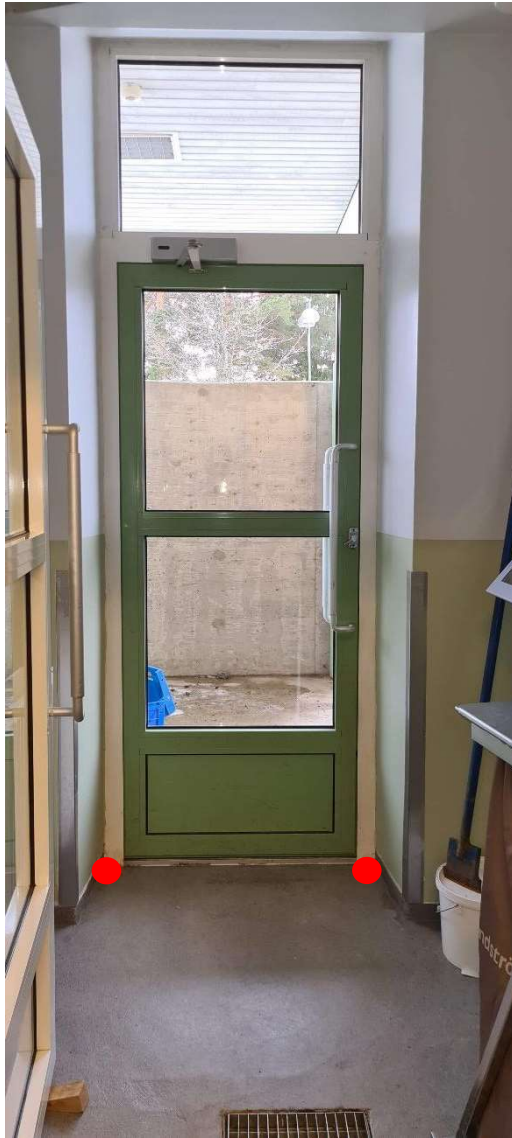
30. Ilmaisut ulko-oven karmin ja lattian liitoskohtiin
