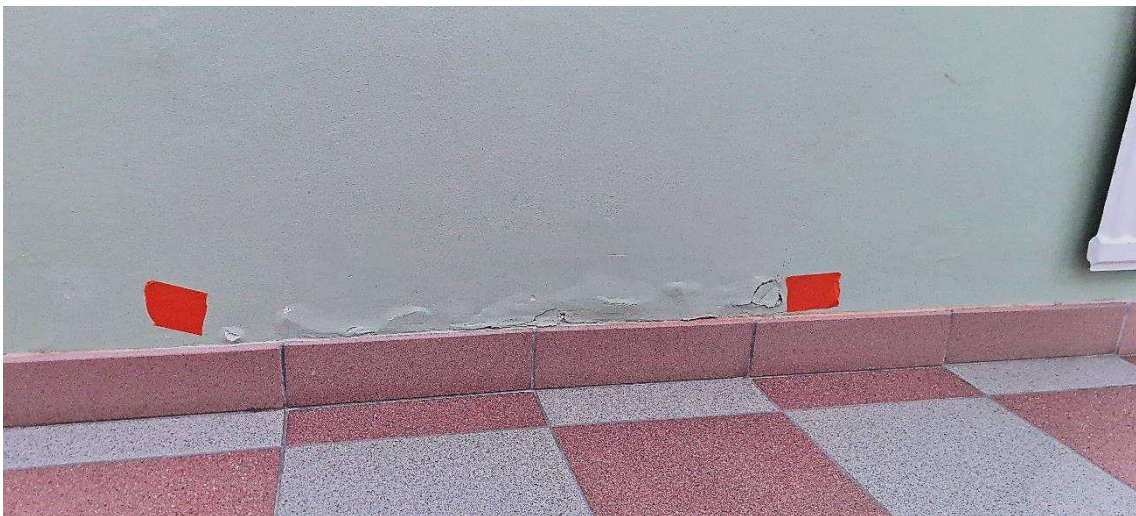
25b. Seinän alaosassa maali kupruilee
