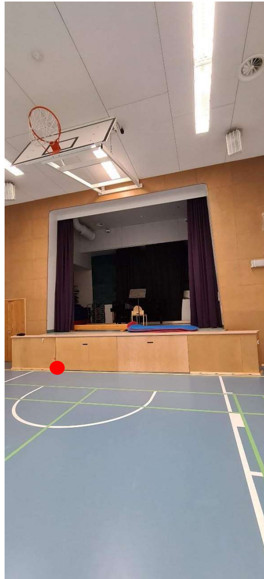
10. Ilmaisu näyttämön alaosan ja lattian liitoskohtaan (alla tuolien säilytyspaikka, jossa havaittiin rakennusjätettä)
